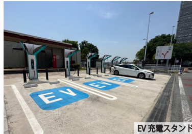
EV充電スタンド
