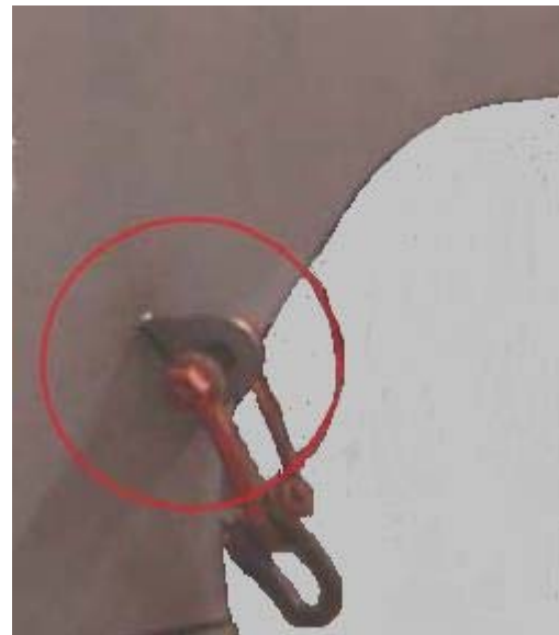
望ましくない吊金具の設置事例
