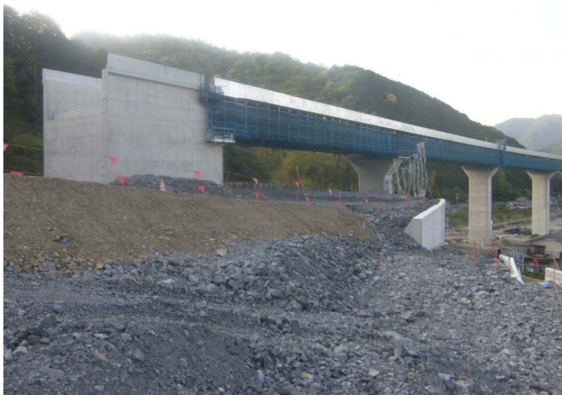
(a) 傾斜が生じた橋台
