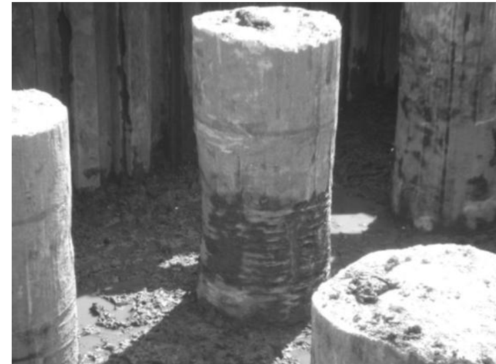
場所打ち杭の細りの事例
