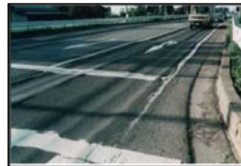
(舗装のわだち掘れ)
