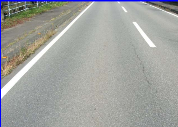
ひび割れ率 5%程度
