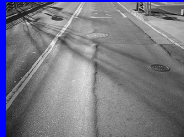
わだち掘れ深さ 40mm程度
