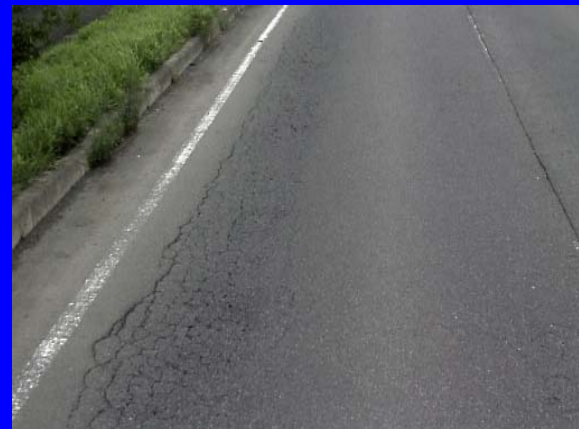
ひび割れ率 35%程度
