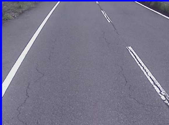
ひび割れ率 20%程度
