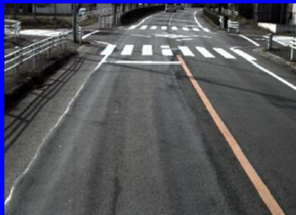
わだち掘れ深さ 30mm程度
