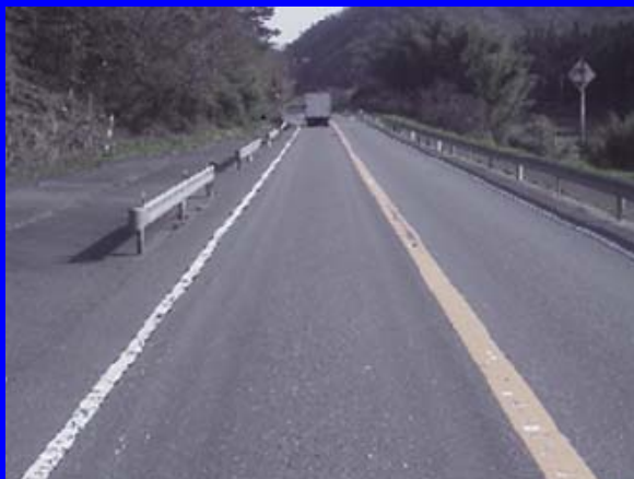
わだち掘れ深さ 15mm程度
