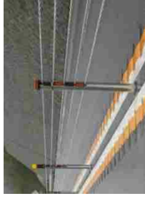
<ワイヤロープの設置事例>
