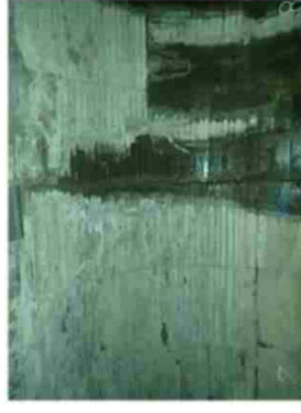
損傷状況（うき・漏水）
