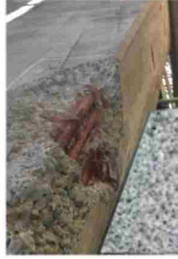
損傷状況（鉄筋露出）
