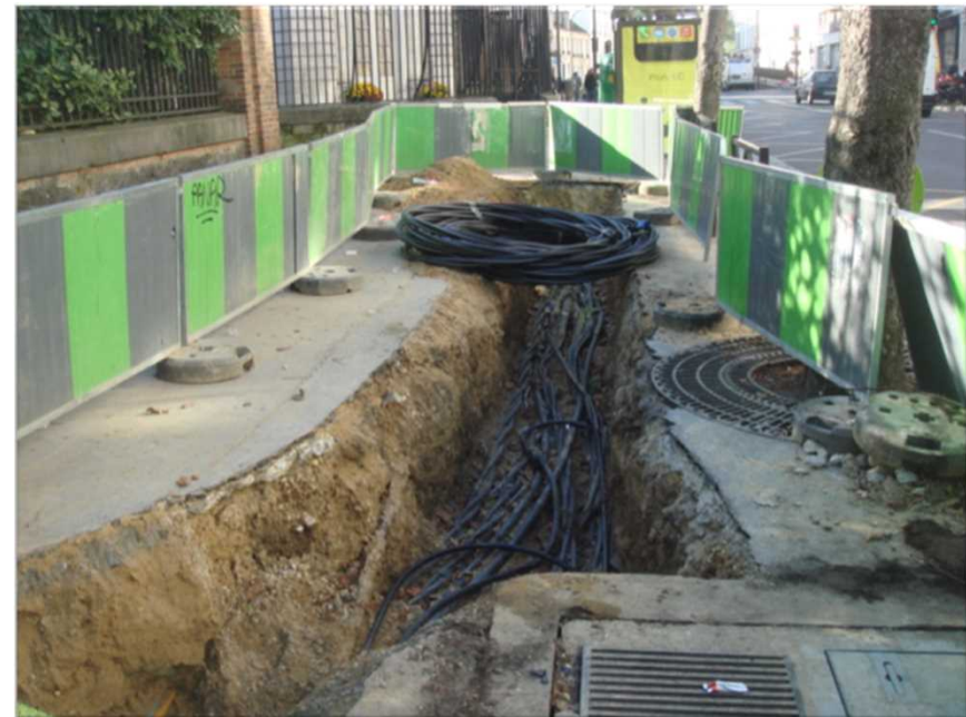
パリ市内におけるケーブルの直接埋設状況
