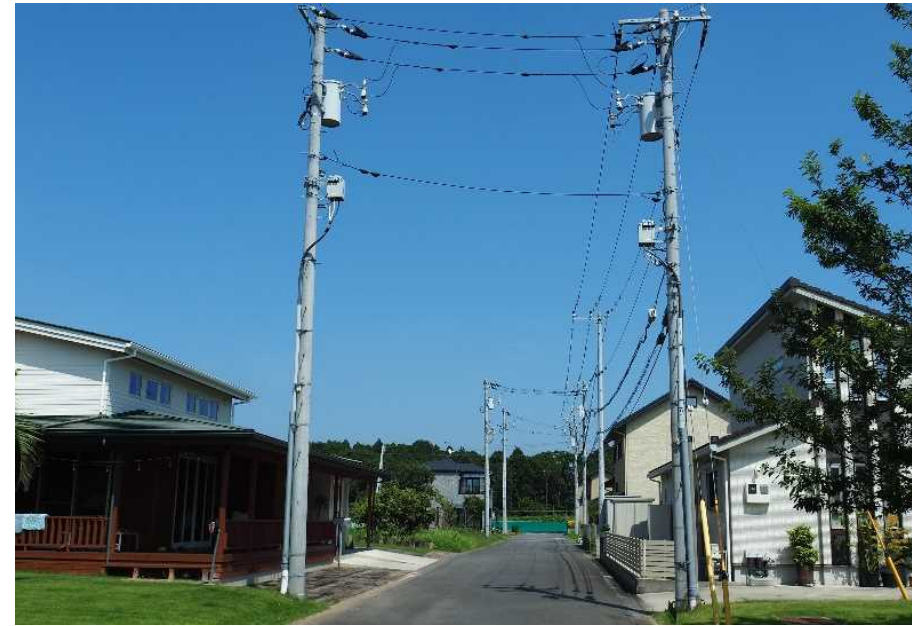
電線を設置した道路（架空線路線）
