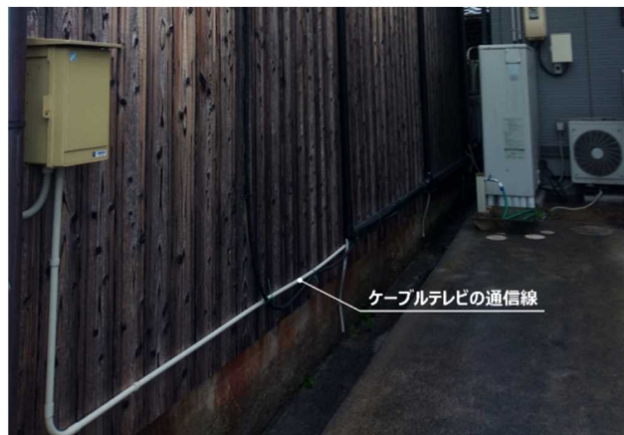
側溝を伝って裏配線で引き込んだケーブルテレビの通信線
