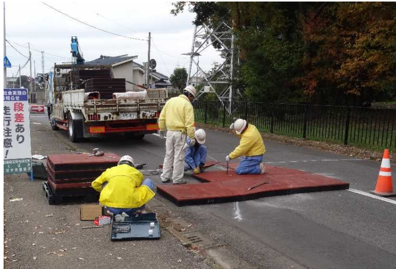
国総研の可搬型ハンブを使用した設置事例(社会実験)
