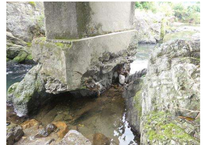
地方自治体管理 橋脚洗掘
