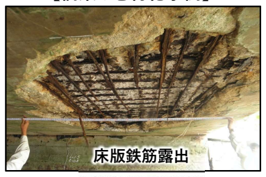
【橋梁の老朽化事例】
