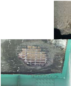
(床版下面) 床版の抜け落ち
