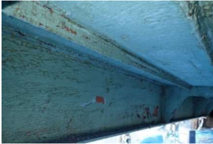
桁の塗装劣化やさびの発生
