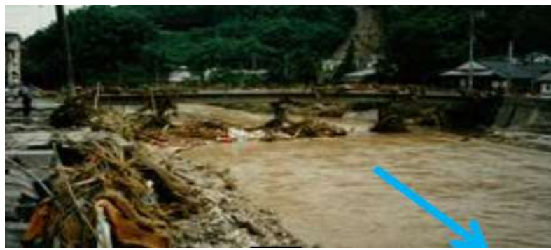
径間長不足、河積阻害による支障事例
