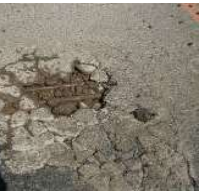
(床版上面) 舗装土砂化
