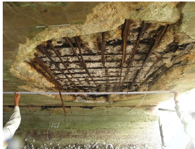
地方自治体管理 床版鉄筋露出
