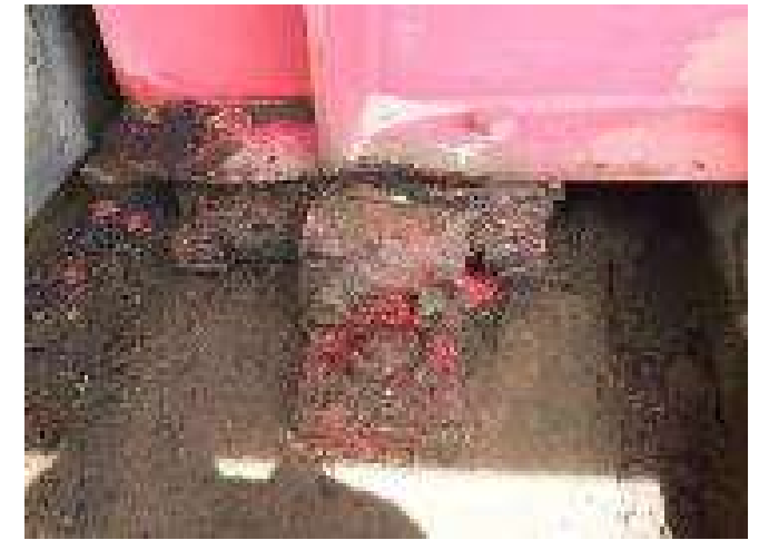
地方自治体管理 支承腐食
