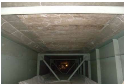
ひび割れの発生
