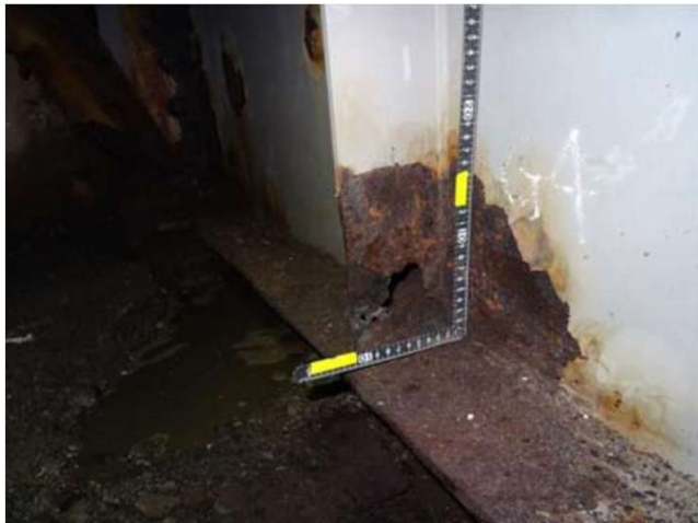
国管理 主桁腐食・欠損
