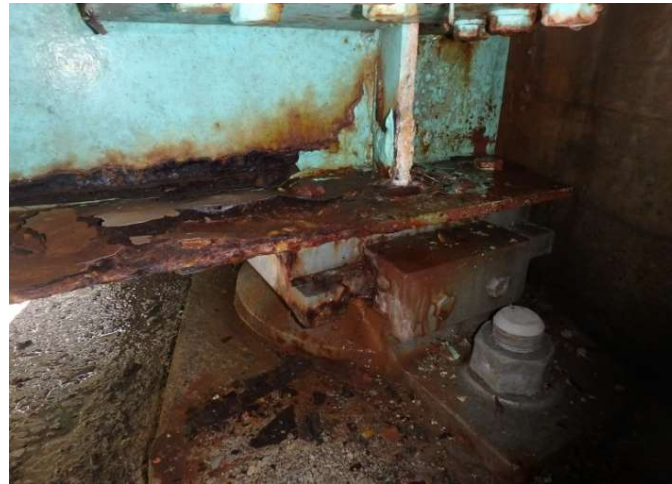
地方自治体管理 主桁腐食
