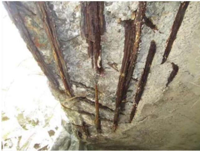
国管理 床版鉄筋露出
