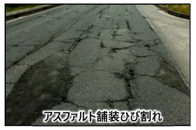
【舗装の老朽化事例】
