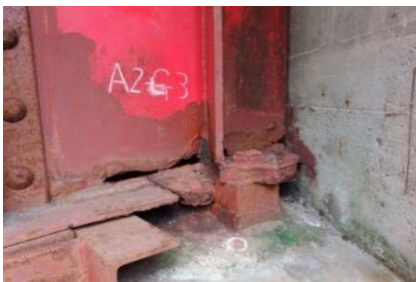
桁端部の腐食・貫通
