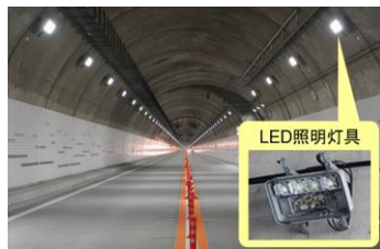
道路照明のLED化
