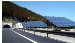
道路空間の太陽光発電設備
