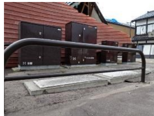
地上機器周辺での段差や路面ひび割れは複数確認
