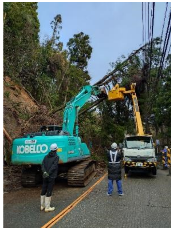
石川県穴水町 県道303号
