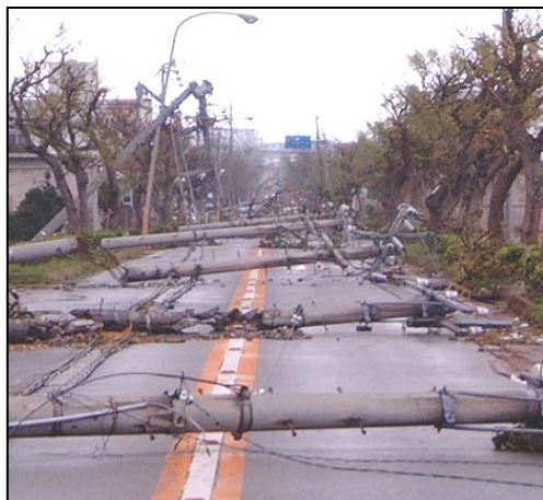
<電柱の倒壊による道路閉塞>
