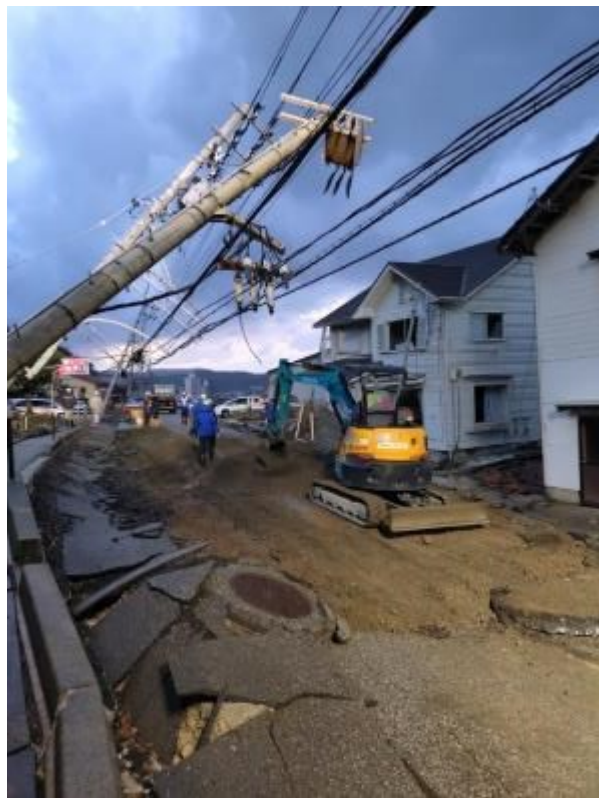
石川県輪島市 国道249号
