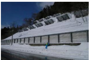
雪崩対策の例（雪崩防止柵）
