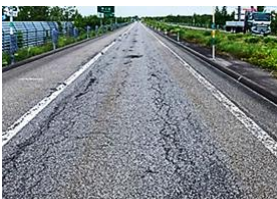
アスファルト路盤の損傷
