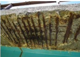
床版鉄筋の露出
