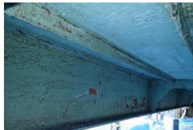
桁の塗装劣化やさびの発生
