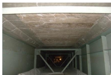
ひび割れの発生
