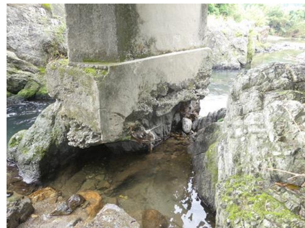
地方自治体管理 橋脚洗掘
