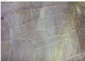
下部工のひび割れ
