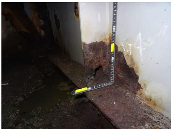
国管理 主桁腐食・欠損
