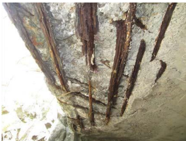
国管理 床版鉄筋露出
