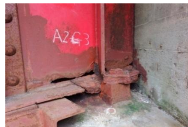
桁端部の腐食・貫通
