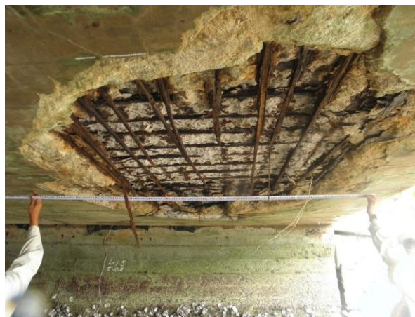
地方自治体管理 床版鉄筋露出
