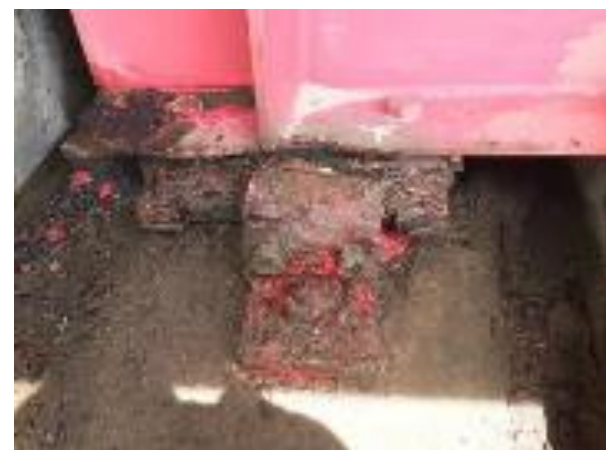
地方自治体管理 支承腐食
