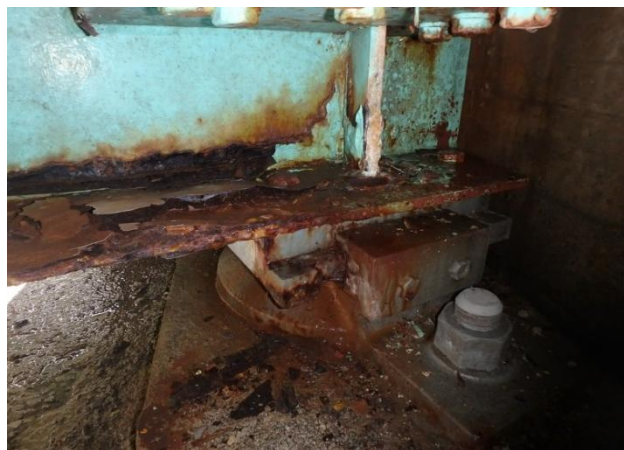
地方自治体管理 主桁腐食
