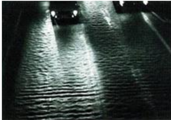
図 3-3 アスファルト舗装の縦方向の凹凸
