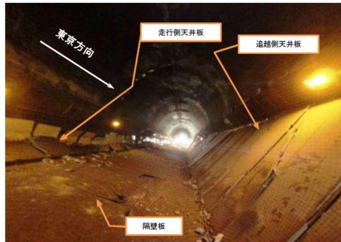
図 1-25 笹子トンネル天井板落下事故 6)
