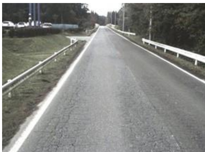
図 3-1 アスファルト舗装のひび割れ
