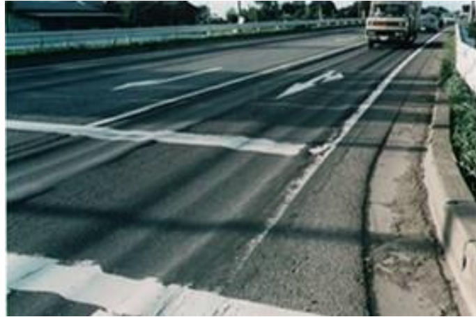
図 3-2 アスファルト舗装のわだち掘れ
